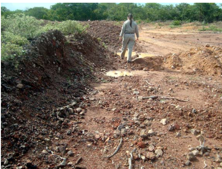
Área aberta por máquinas ao lado da rodovia.
